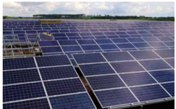
CENTRALES AU SOL À RION-DES-LANDES (40) - PUISSANCE : 10,5 MWc
