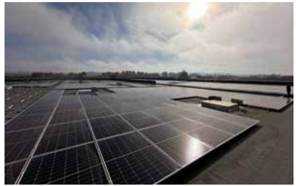
MAGASIN CENTRAKOR À CARBONNE (31) - PUISSANCE : 498 kWc
